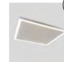
Plafondbevestiging, gecombineerd met een los ledverlichtingselement
